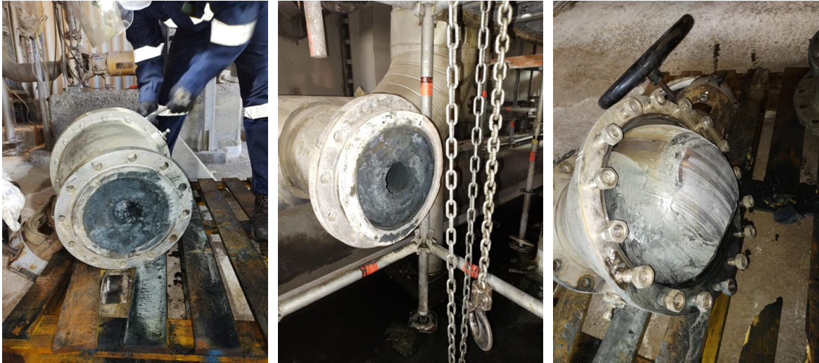
Figura 4.24: Líneas de licor verde obstruidas en las cercanías de la Bomba 303.
