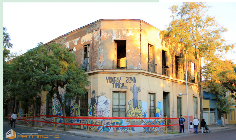
Fig. 4: Deterioro de edificio en Barrio Yungay. Fuente: Plataforma Urbana (2011).
