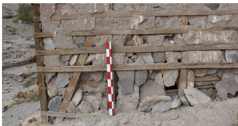
Figura 41. Sobrecimiento en fachada poniente Iglesia Cerro Blanco. Fuente: Colección del autor (2022)
