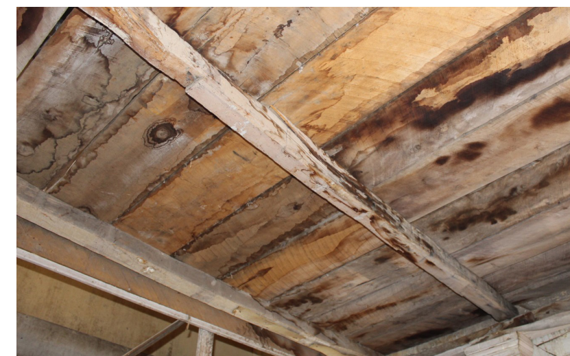
Figura 69. Maderas de entepiso coro con pudrición por infiltración de aguas lluvias. Fuente: Colección del autor (2021).
