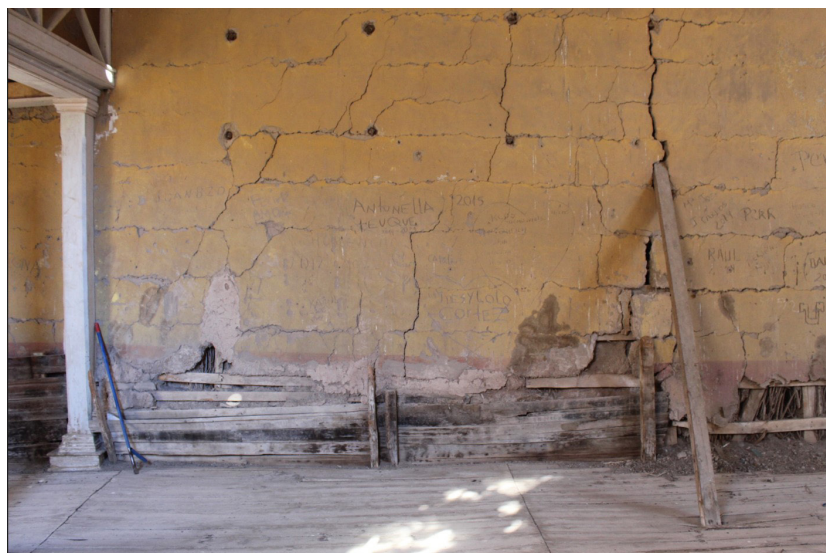
Figura 67. Estado de conservación muro sur interior. Fuente: Colección del autor (2021).
