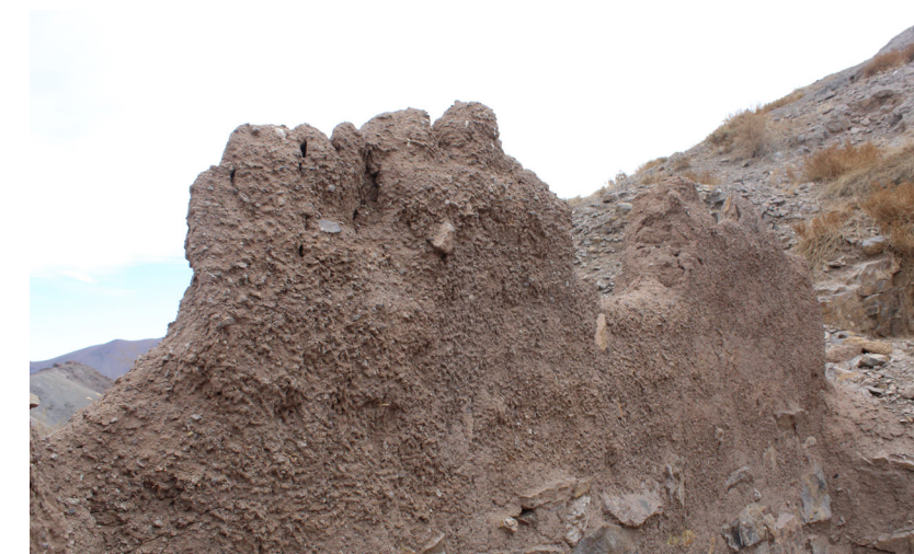
Figura 54. Muro conglomerado tierra - piedra al poniente de la sede.
