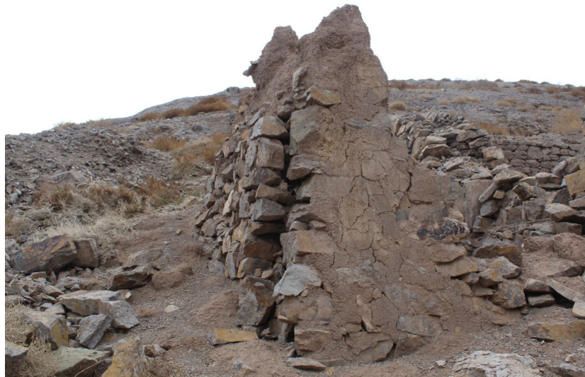
Figura 76. Muro conglomerado de tierra y piedra con pérdida de sección por acción del agua.
