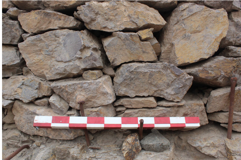
Figura 75. Pérdida de morteros de tierra en muro sur sede social.
