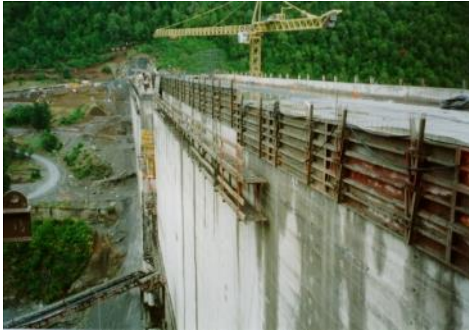
Ilustración 80: Moldaje para conformar el paramento de aguas arriba de la presa Pangué. Fuente: Luis Uribe.
