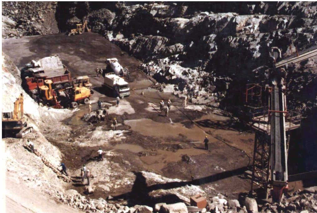
Ilustración 81: Actividades de preparación de superficie, en la fundación de la presa, y colocación de primeras capas, presa Pangué. Fuente: Luis Uribe.
