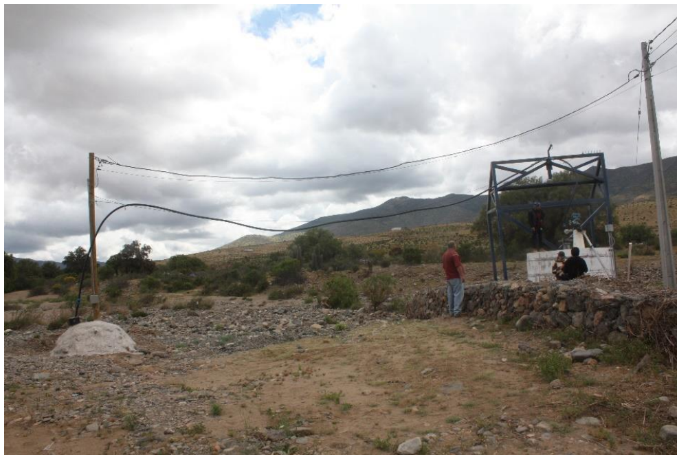
Ilustración 21: Solución temporal realizada por APR Higuieritas Unidas, alimentación de la noria a través de pozo profundo mediante tubería de HDPE .
