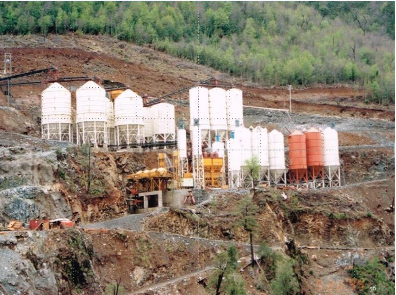
Ilustración 77: Planta de producción de HCR para la construcción de la Presa de la central Pangue. Fuente: Adolfo Ochoa.
