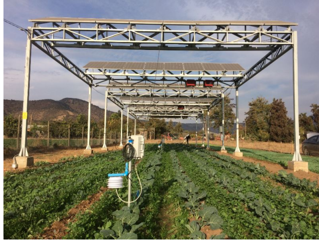
Figura 4.13: Planta APV de Fraunhofer CSET en Curacaví, Chile [57].
