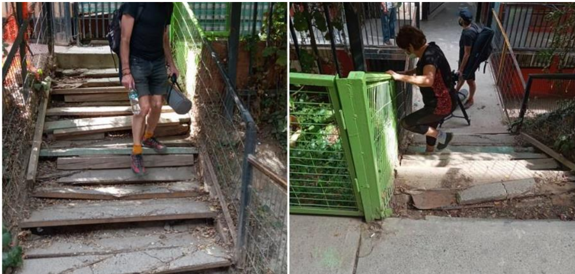
Imagen 8: Fotografías de una escalera en mal estado.
