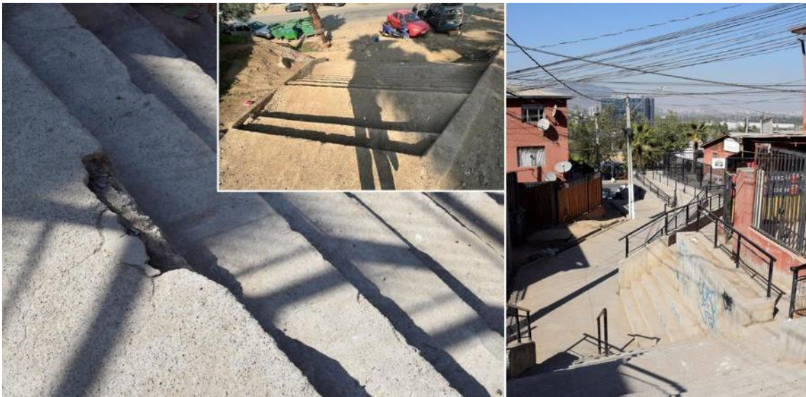
Imagen 7: Fotografías del diseño y estado de las escaleras principales entre Las Canteras 1 y 2.
