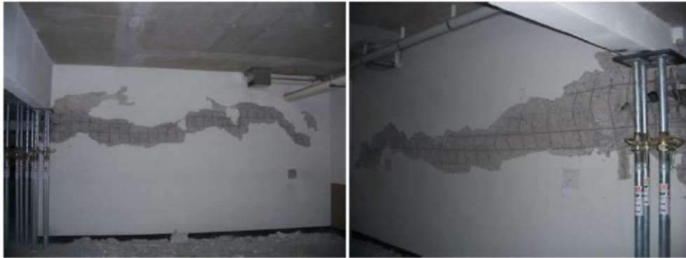
Figura 1: Daño en muros de hormigón armado [Massone et al., 2012]
