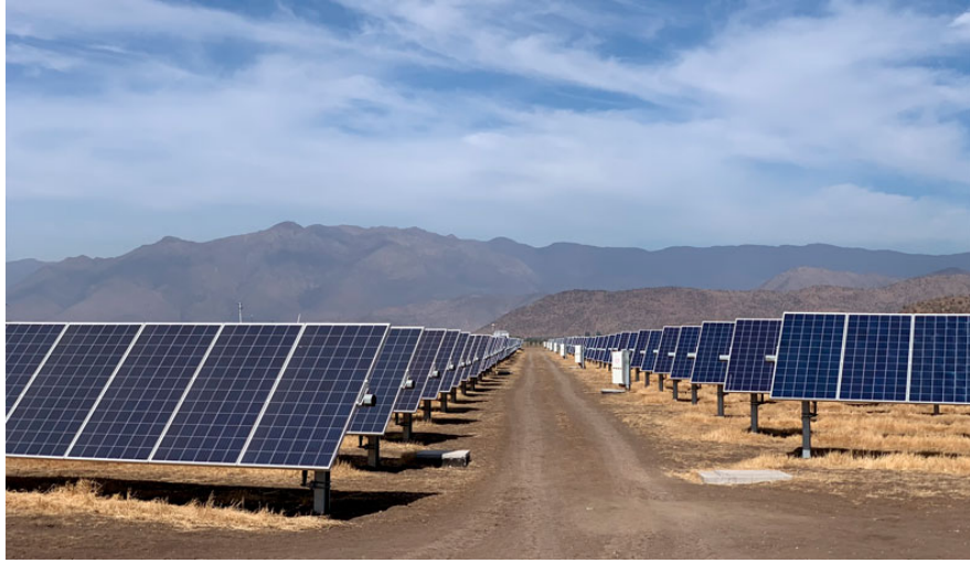
Figura 4.1: Planta solar Ovejería. Fuente: Colbun.cl
