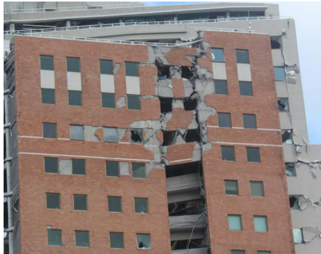
Figura 2.2: Edificio O'Higgins (Concepción) después del terremoto del Maule del 2010 [31]
