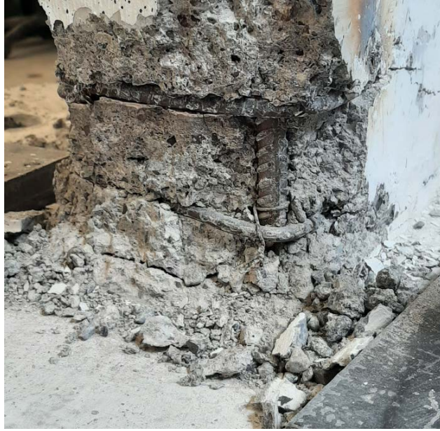
Figura 6.72: Barra de refuerzo en el borde inferior derecho del MR2 al finalizar el ensayo
