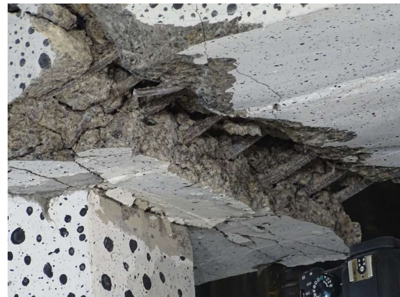
(b) Losa superior dañada.
