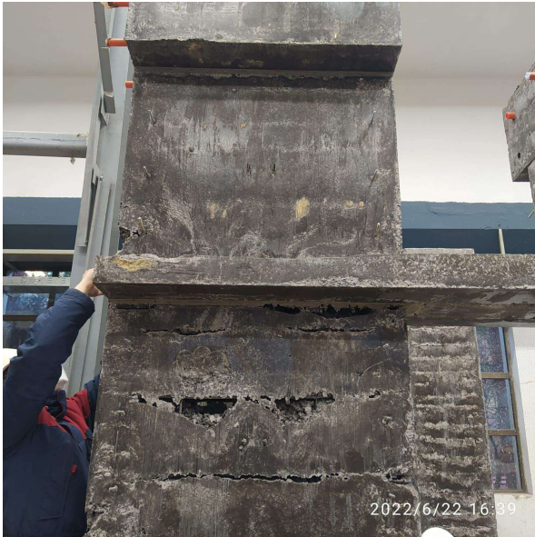
(a) Zona a reparar M1.
