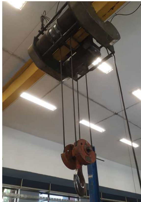
(b) Puente grúa 17 .
