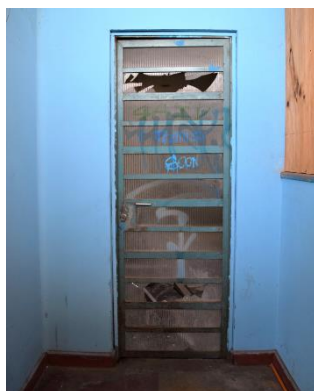
Figura 4-17: Daño en puerta.
