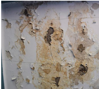
Figura 4-15: Losa con daños por humedad.
