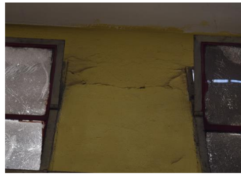
Figura 4-23: Daños en columna corta.
