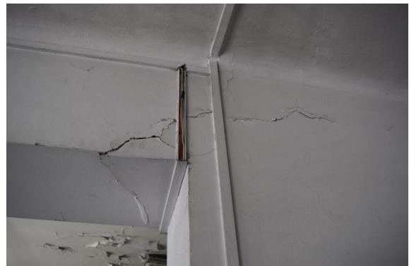
Figura 4-16: Grieta en viga.
