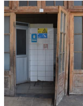
Figura 4-31: Puerta mal anclada.
