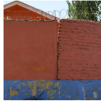
Figura 4-35: Daños muro perimetral.
