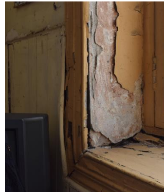
Figura 4-29: Daños en muros internos.
