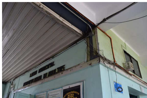
Figura 4-18: Cableado expuesto y abandonado.
