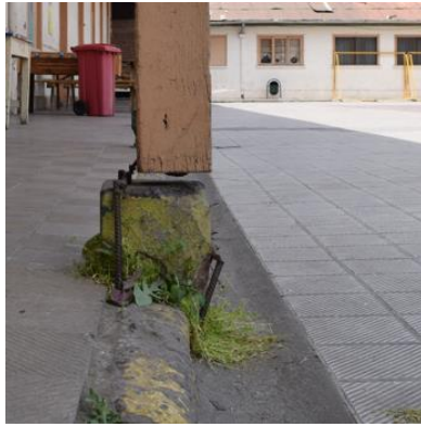
Figura 4-28: Columna mal anclada.
