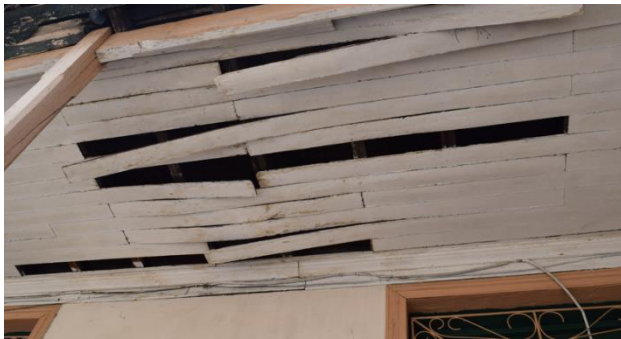
Figura 4-30: Tablones de madera desprendidos del techo.
