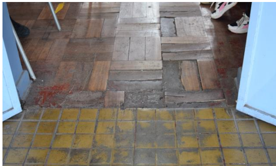
Figura 4-36: Piso de madera dañado.
