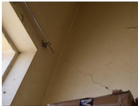
Figura 4-22: Daños en muros.
