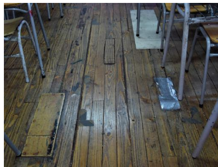
Figura 4-25: Suelo sin tabloncillos y parchado.
