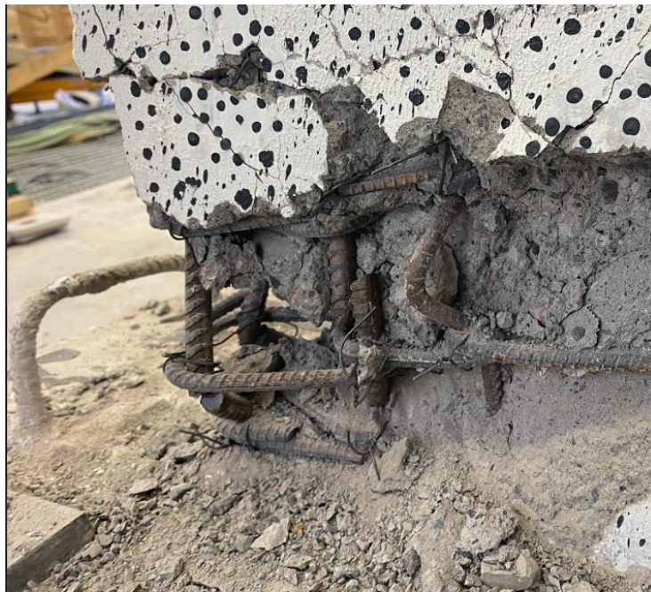
Figura 4.31: Corte de Barras Longitudinales Tercer Ciclo Deriva 2,5%
