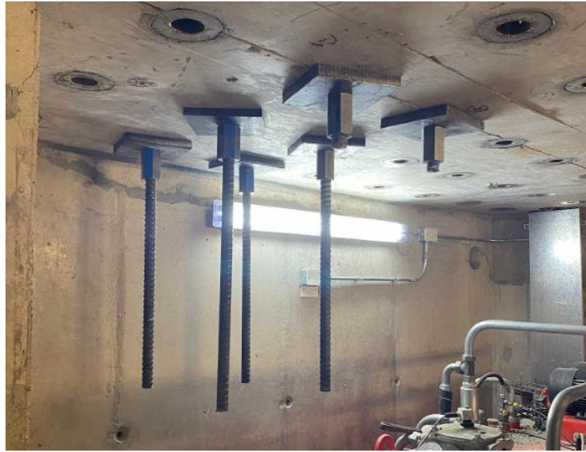
Figura 3.11: Vista de Barras Postensadas
