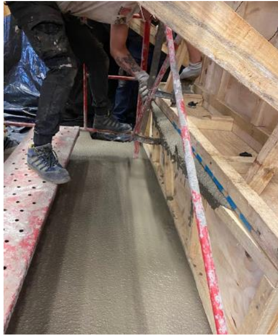
Figura 2.22: Rotura de Moldaje Fundación
