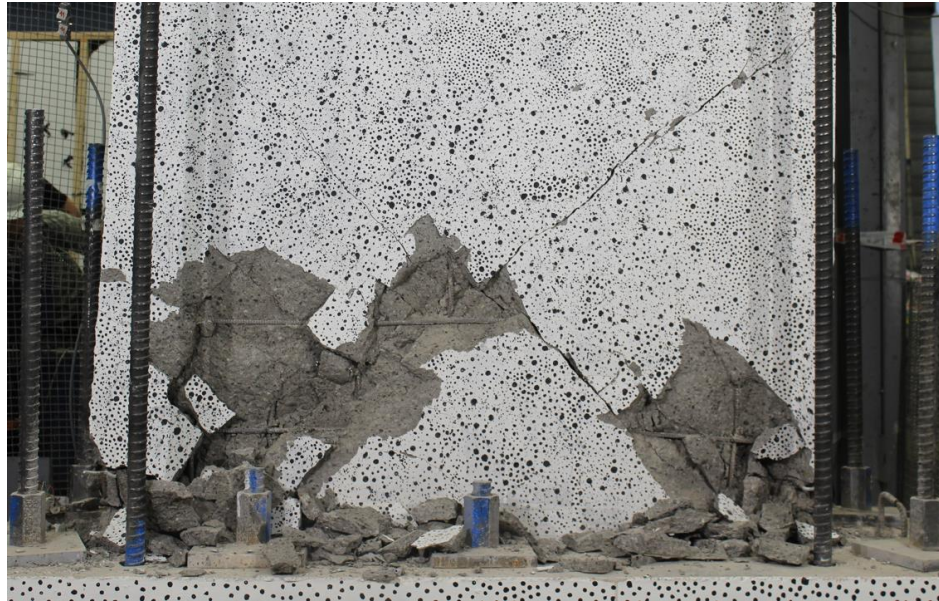
Figura 4.43: Modo de Falla Muro Convencional
