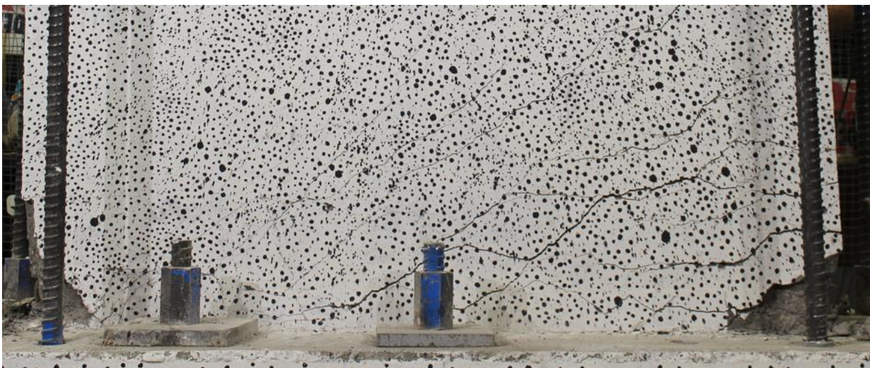
Figura 4.29: Patrón de grietas primer ciclo deriva 2,5%
