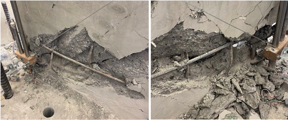
Figura 4.13: Pandeo de Barras Verticales del Alma, Vista Lado Sur
