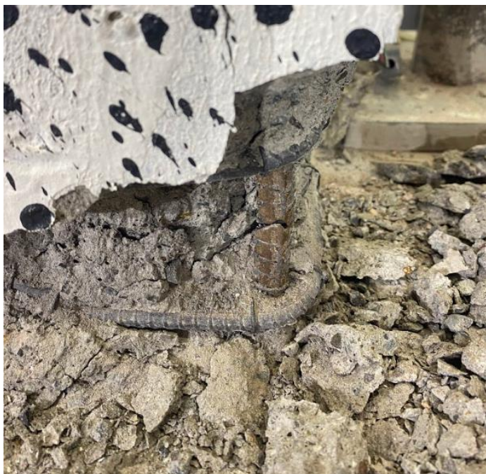
Figura 4.28: Corte de barra longitudinal primer ciclo deriva 2,5%, lado oeste
