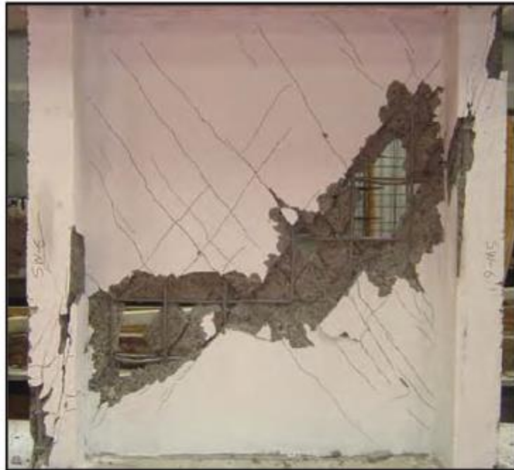
Figura 1.4: Falla por Compresión Diagonal (Dabbagh et al. 2005)
