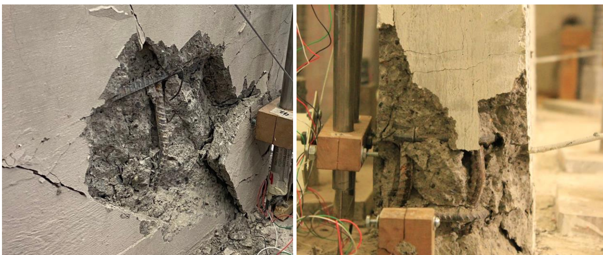
Figura 4.9: Pandeo Barras Armadura de Repartición (Izq) y de Borde (Der)
