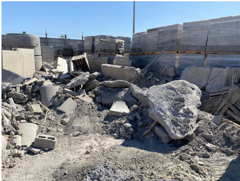
Ilustración 10: Estado de los residuos (b)
