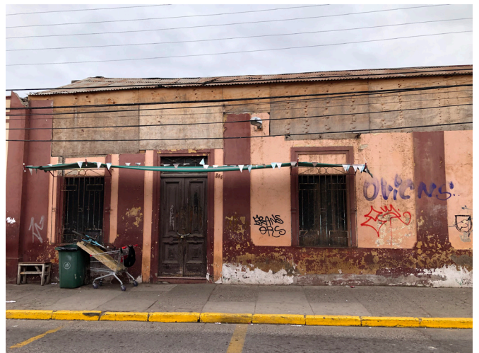
Viviendas mal conservadas calle Vicente Zorrilla Imagen 22. Fuente: Elaboración propia.
