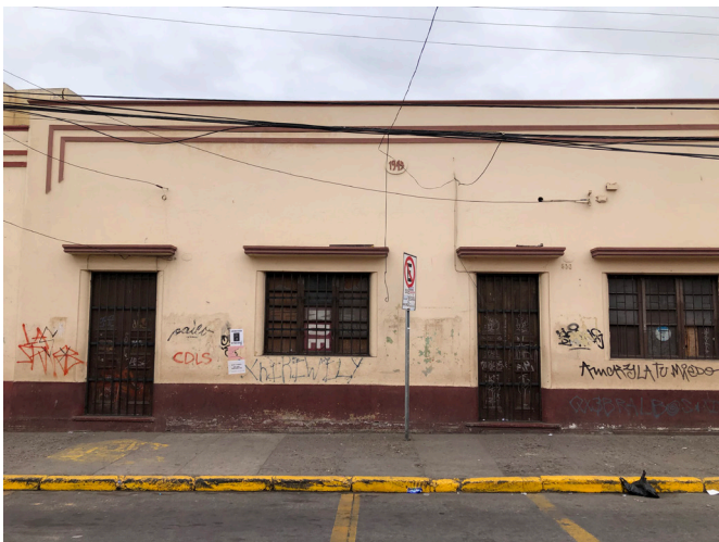
Viviendas mal conservadas calle Vicente Zorrilla Imagen 21. Fuente: Elaboración propia.
