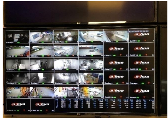
CCTV Sala TI
