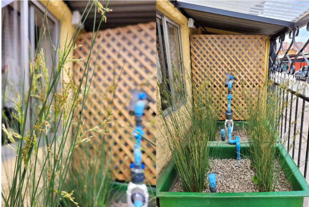
Figura 25. Estado de la zona de tratamiento biológico después de 5 meses transcurridos desde la instalación del sistema completo.
