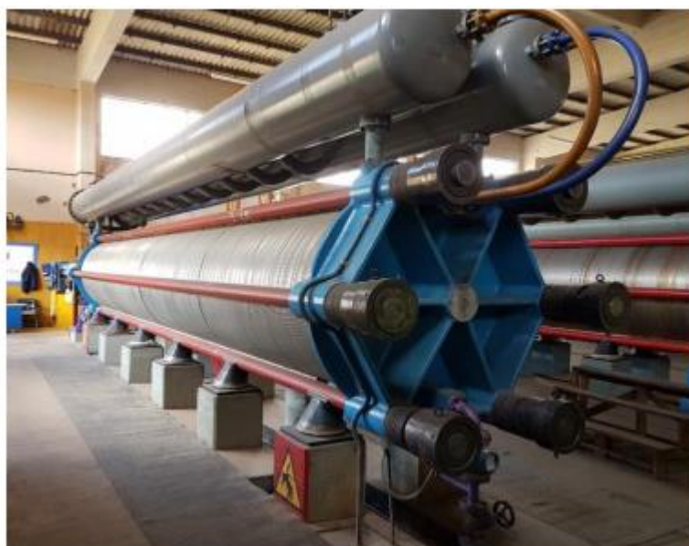
Figura 4. Electrolizador alcalino representativo, es decir, de similares características será utilizado para el proyecto. La planta contará con 5 equipos de tecnología alcalina con una capacidad estimada de 5 MW cada uno (ENGIE LATAM S.A., 2021)
