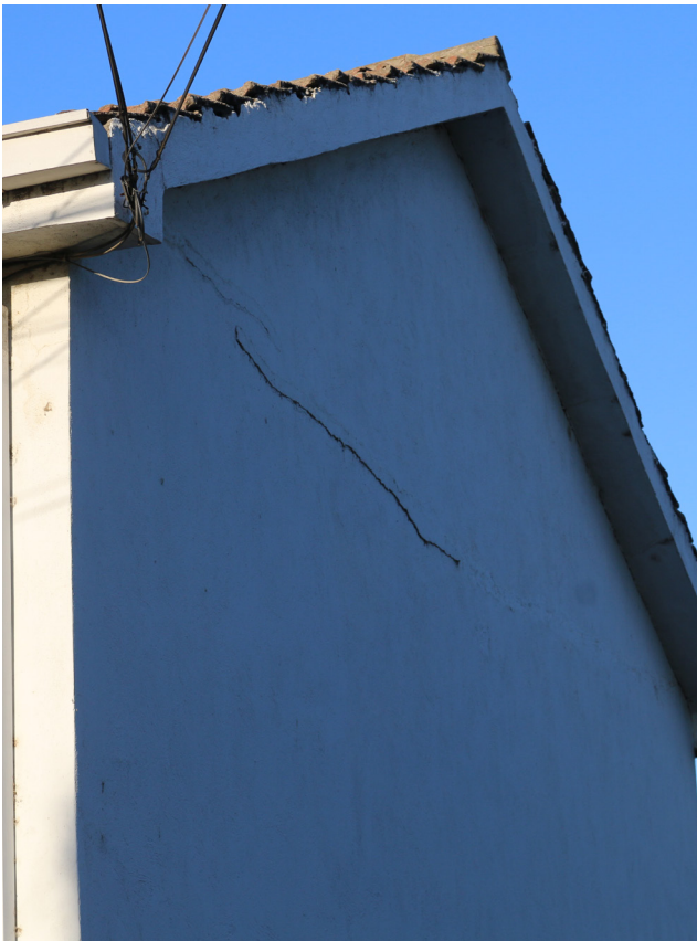
Imagen 99: Detalle grieta lateral, 2023 Fuente: Patricia Wyser A.
