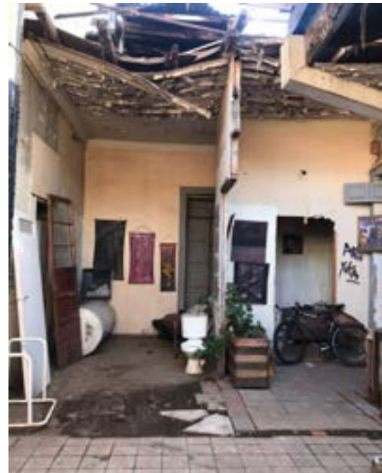
Fig. 16. Techumbre en estado de derrumbe. Fuente: Elaboración propia.
