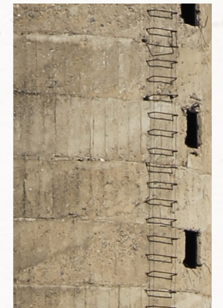
Paredes de silo Fuente: Archivo propio
