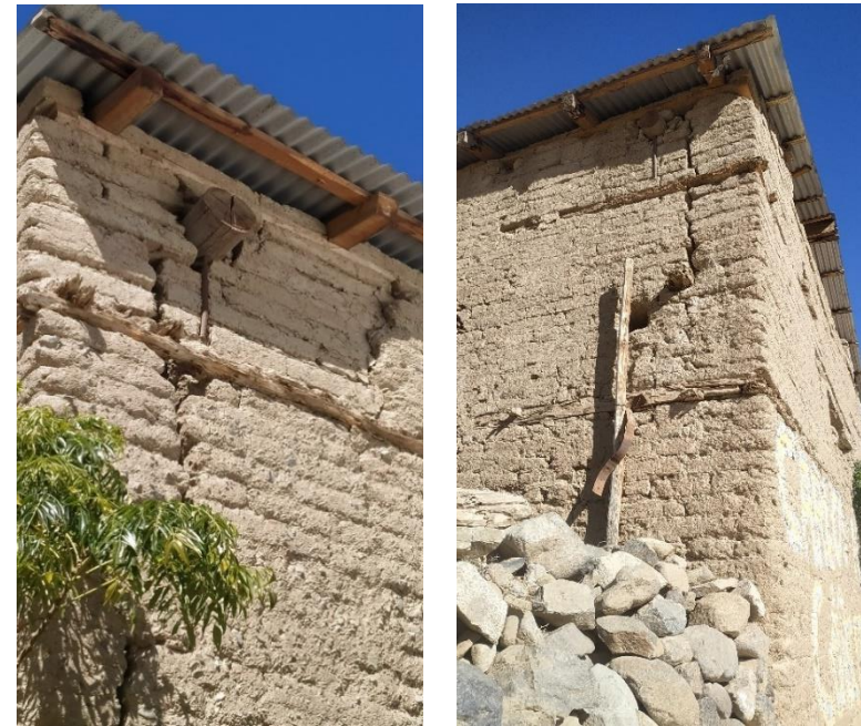
Figura 85: Dispositivos de refuerzo en fachadas afectados por xilófagos. Fuente: Archivo propio.
