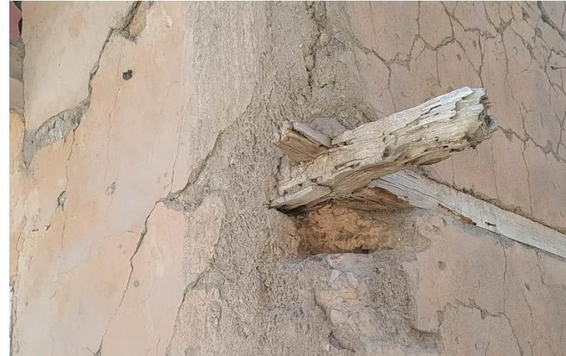
Figura 65: Dispositivo DC afectado por xilófagos. Fuente: Archivo propio.
