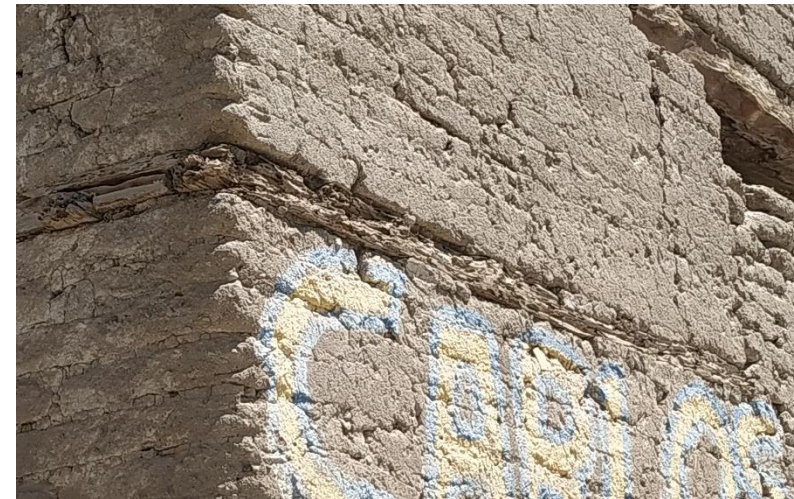
Figura 66: Dispositivo DC con una pérdida casi total de sección a causa de xilófagos. Fuente: Archivo propio.
