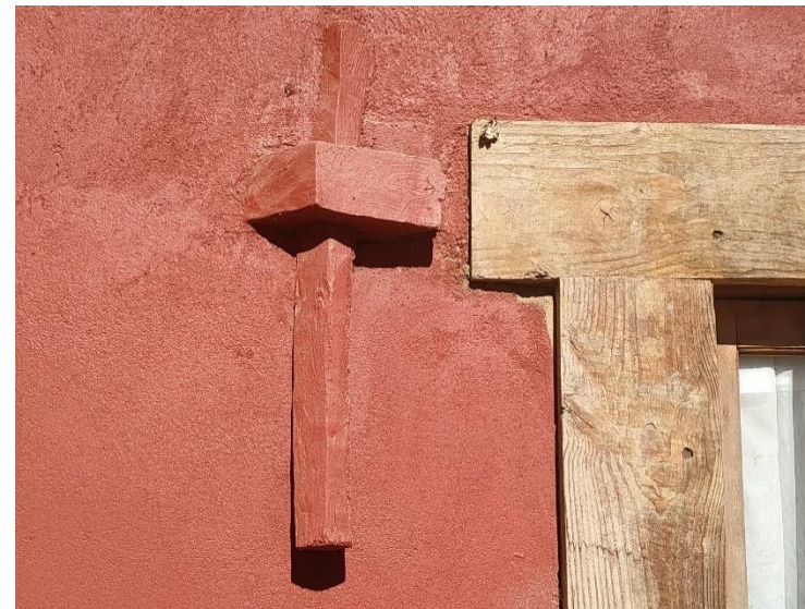
Figura 72: Dispositivo DE en una vivienda intervenida de Tulahuén. Fuente: Archivo propio.
