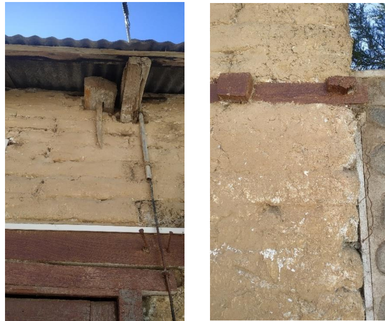
Figura 79: Dispositivos de refuerzo del inmueble. Fuente: Archivo propio.
