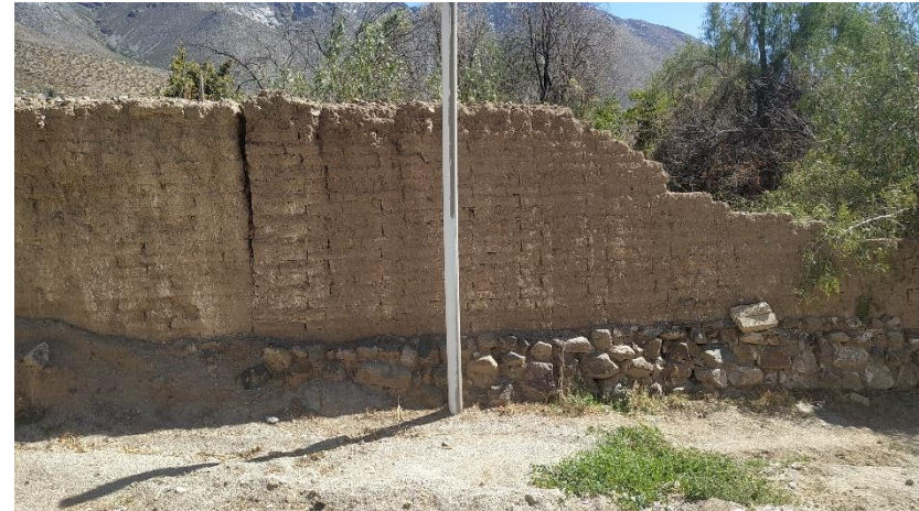
Figura 49: Cerca de albañilería de adobe simple sobre cimiento de piedra en Tulahuén. Fuente: Archivo propio.
