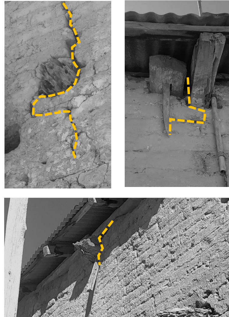
Figura 103: Daños comunes en el muro asociados al dispositivo DP. Fuente: Elaboración propia.
