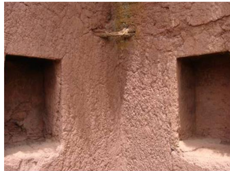
Figura 70: Detalle de refuerzo en muros de Huachay Qosqo, Perú. Fuente: Miguel Ángel Yépez.
