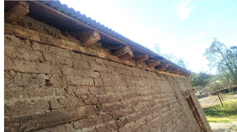
Figura 67: Ring beam o viga collar en una vivienda de Tulahuén. Fuente: Archivo propio.
