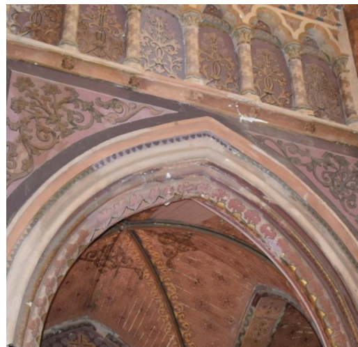
(c) Daño en arco del ábside
