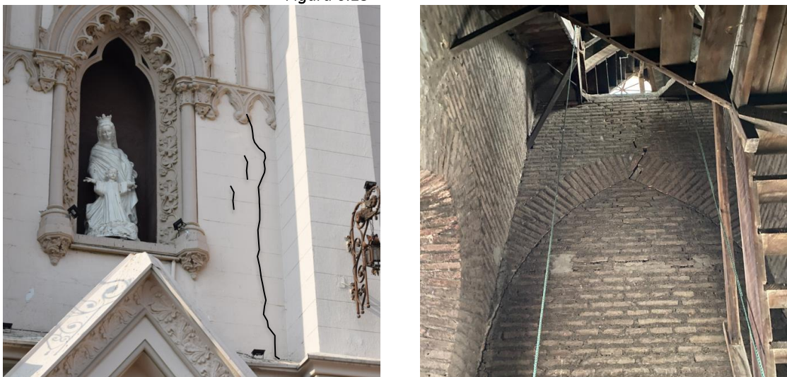
(a) Fisuras verticales por el exterior de la torre
