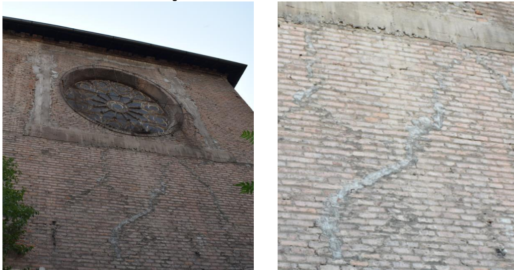
(a) Fisuras verticales en muros testeros
