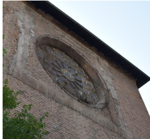
(d) Confinamiento de rosetones
