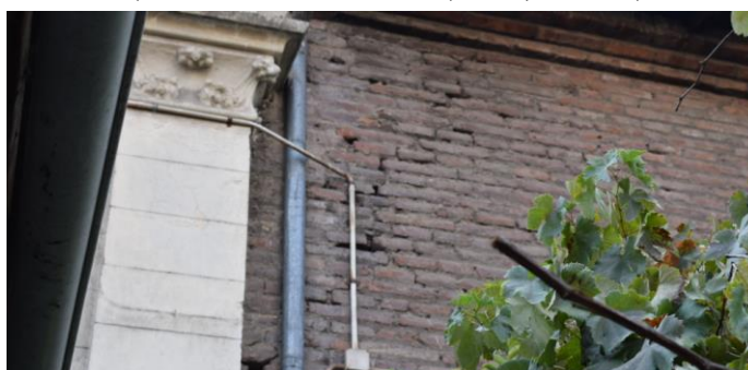
d) Registro del daño (ver capítulo 6.4)
