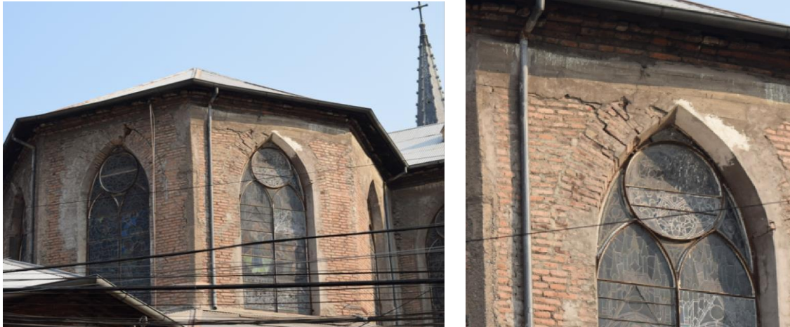
(a) Daños en el ábside
