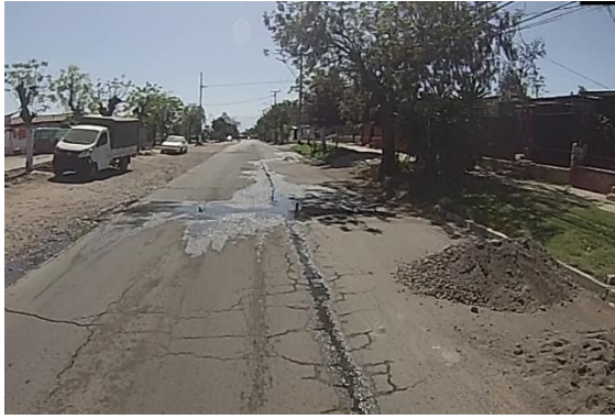
Figura 13: Calle de Maipú mal pavimentada, con pobre vegetación y una poza de agua. Fotovoz Isidora, minuto 18:57. Fuente: Elaboración propia.
