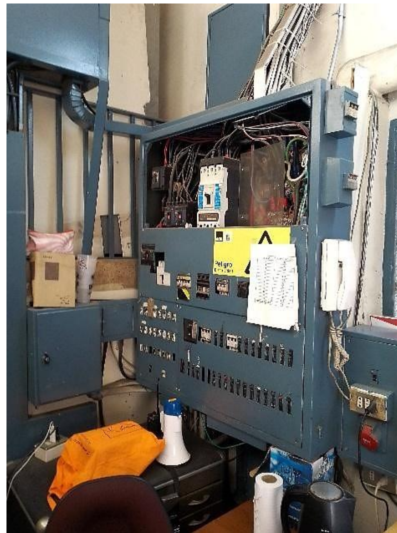
Figura 148. Tablero general Primer piso, Archivo Personal.
