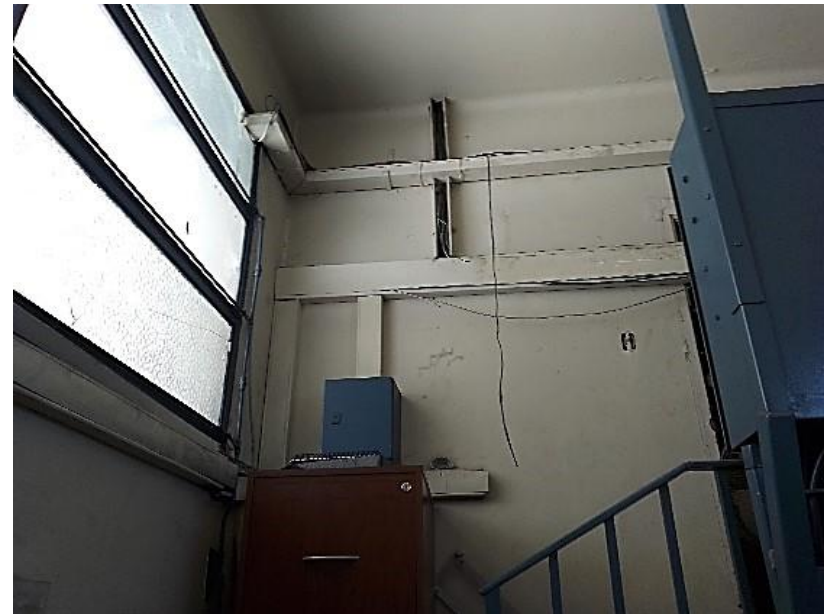
Figura 153. Oficina Recepción, Primer piso, Red eléctrica, Archivo Personal.
