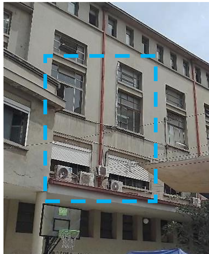
Figura 169. Fachada Interior, Aires acondicionados, Archivo Personal.
