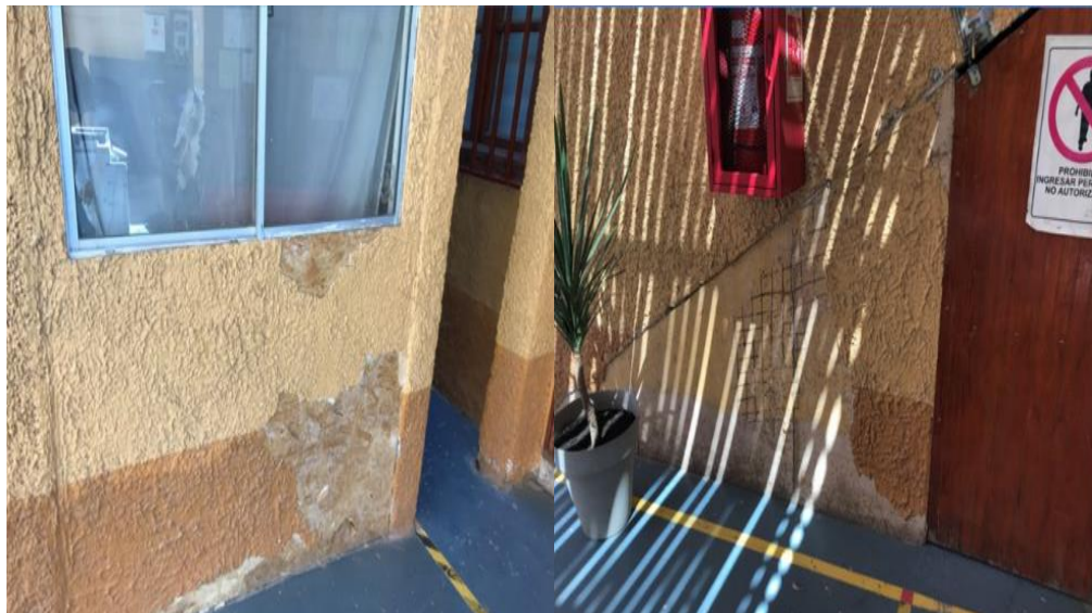
Figura N°45, Estado de la estructura física de la escuela G-52, fuente perfil social COMDES
