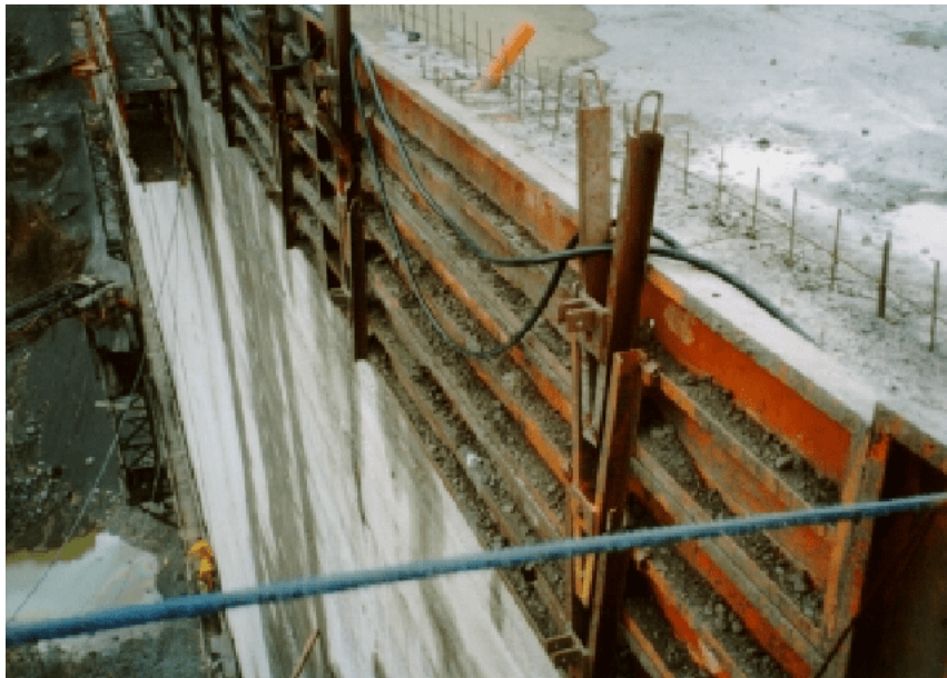
Figura 6.18: Moldajes utilizados en la construcción del paramento aguas arriba en la presa Pangué, Fuente: Adolfo Ochoa Llangato
