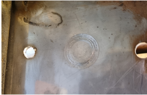
Figura 9.5: Hendidura de la parte interna de la carcasa
