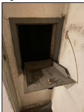
Imagen 5. Ducto del shaft de un edificio
