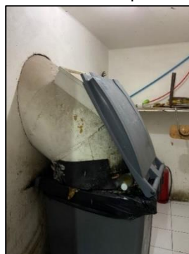
Imagen 6. Contenedor que conecta con el final del shaft
