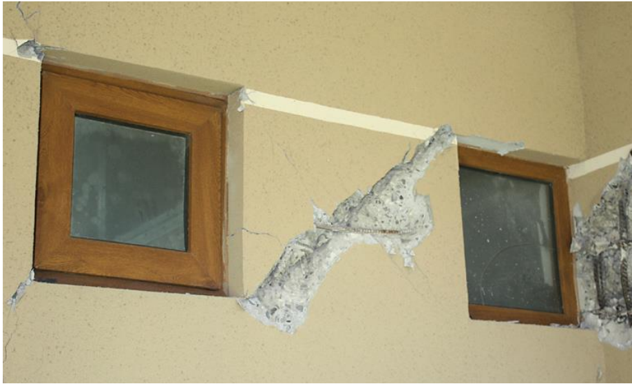
Fig. 2 Daño por corte en elemento de acople (Rojas & Massone, 2012)
