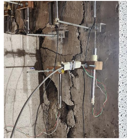
Fig. 25 Desprendimiento del hormigón
