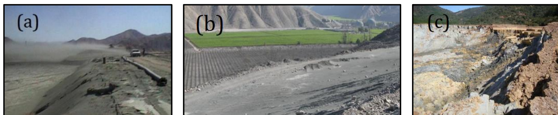
Figura 10.2. (a) Efecto eólico erosivo en tranques de relaves. (b) Daños a la vegetación aledaña. (c) Fallas de tranques ante sismos severos (Minera Florida, 2023).
