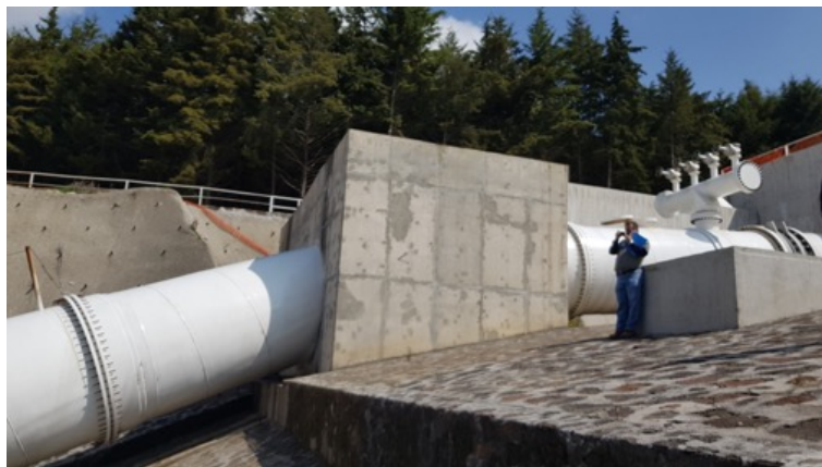
Figura 3.7: Utilización de machón de hormigón como atraque de una tubería a presión. Fuente: Instituto de Ingeniería UNAM, 2021.
