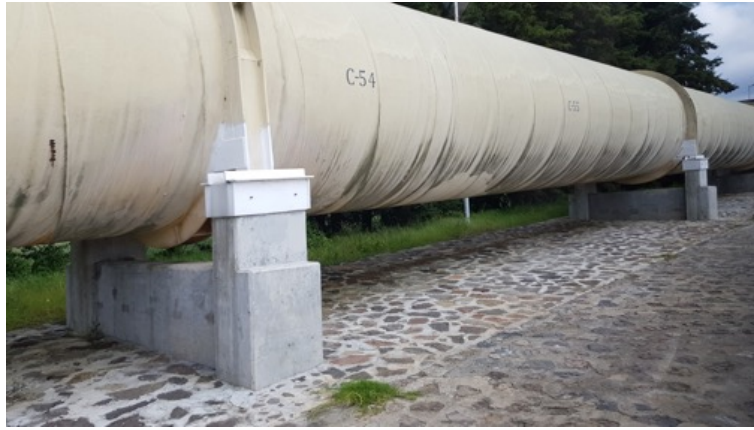
Figura 3.6: Utilización de sillas como apoyo de tuberías de acero. Fuente: Instituto de Ingeniería UNAM, 2021.
