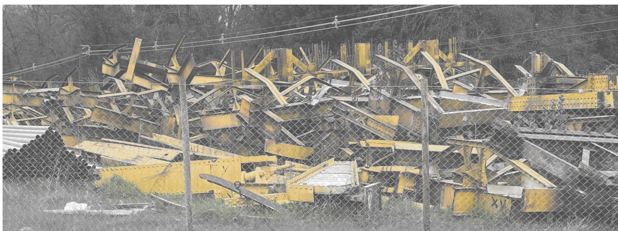
Restos del Puente Toltén - Imagen propia
