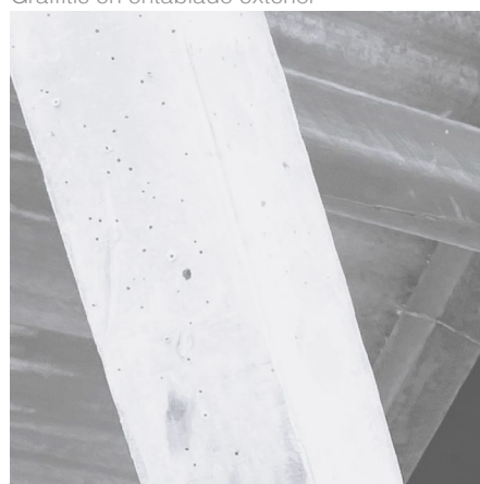
Presencia de xilófagos en diagonales
