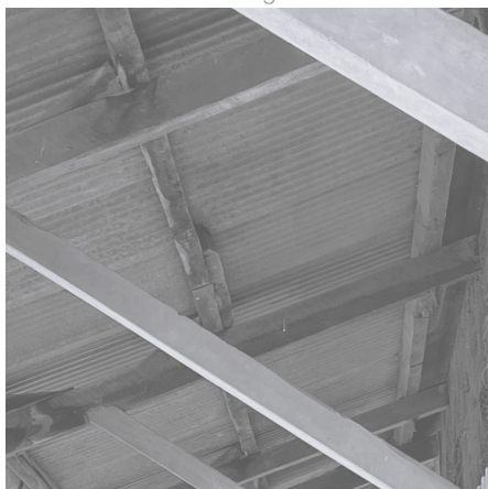
Aristas faltantes en vigas de alero
