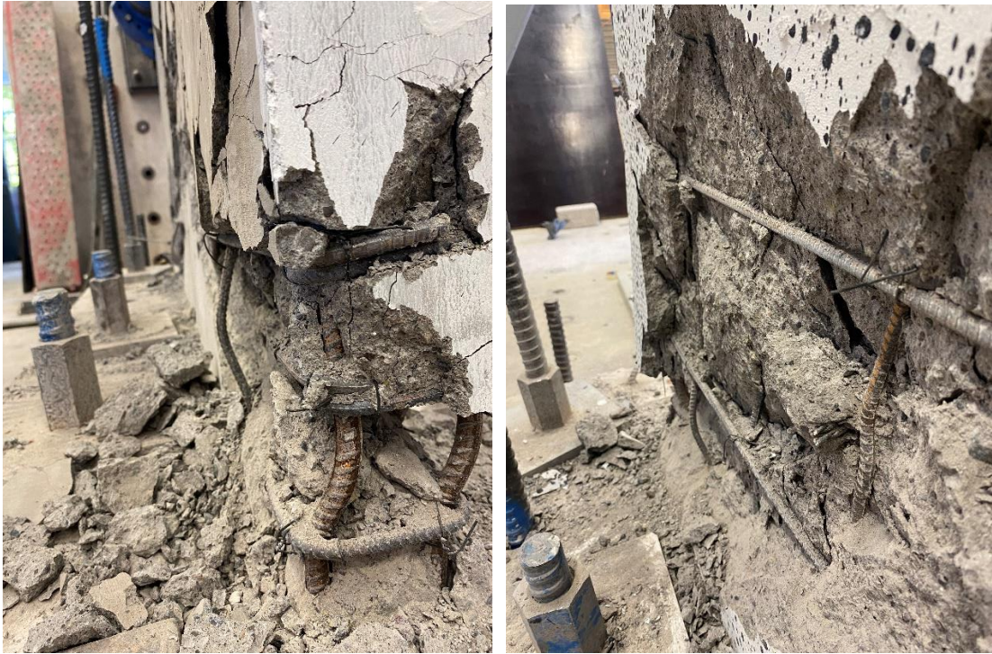
Figura 5.5 : Aplastamiento y descascaramiento del hormigón, acompañado del pandeo de las barras del alma y borde del muro.
