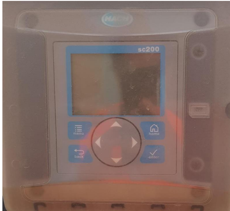
Figura 24: Controlador SC200 HACH.
