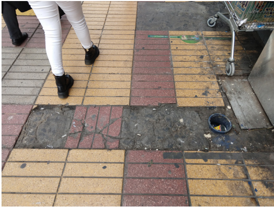
Imagen 43. Estado Actual Pavimentos Fuente: Elaboración Propia
