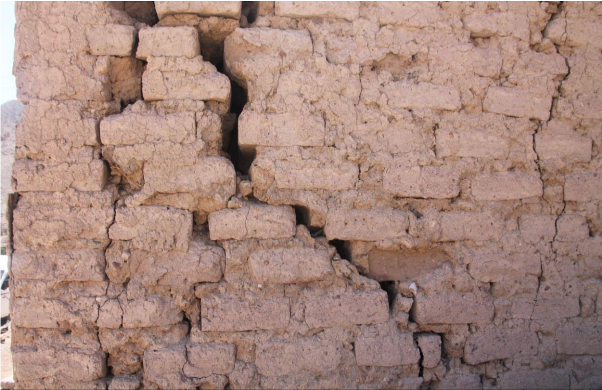
Figura 8: Elaboración propia. Sept, 2022. Falla estructural en un muro de adobe de Mocha después del sismo de 2005. Fotografía.
