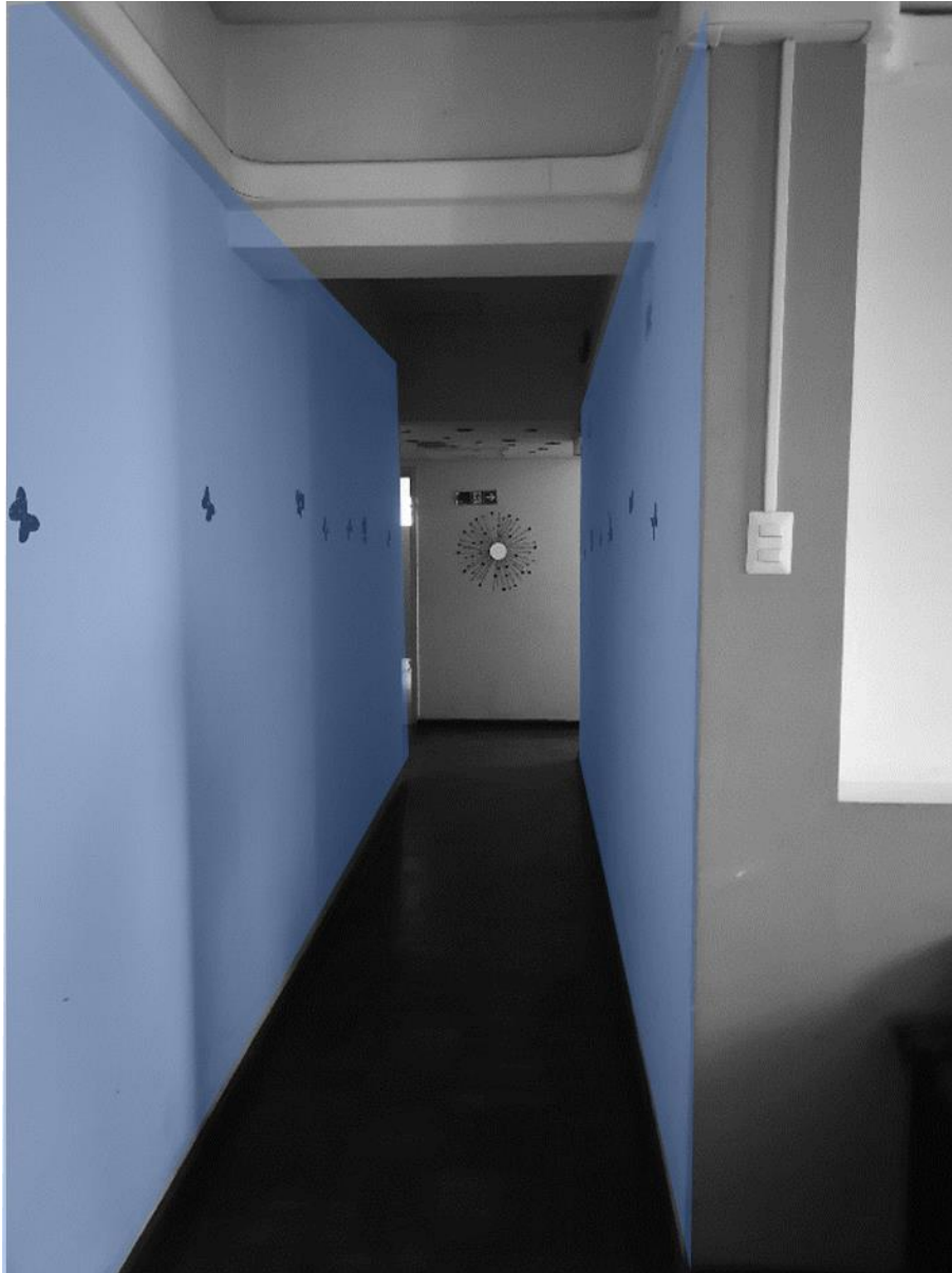
Imagen N°9: Pasillos con muros ciegos de Residencia Mario Ojeda. Fuente: Registro personal de elaboración propia.
