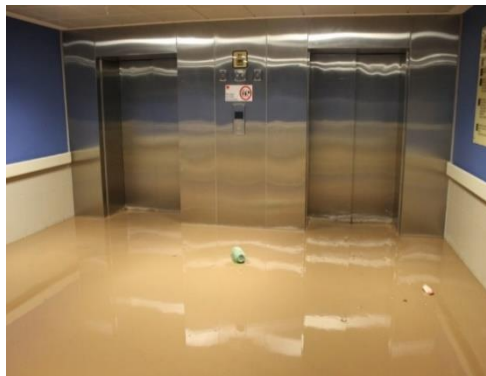
Fotografía 15. Flujo de detritos y de barro que impiden el funcionamiento de los ascensores. Tomado de (Gobierno de Chile, 2015b).
