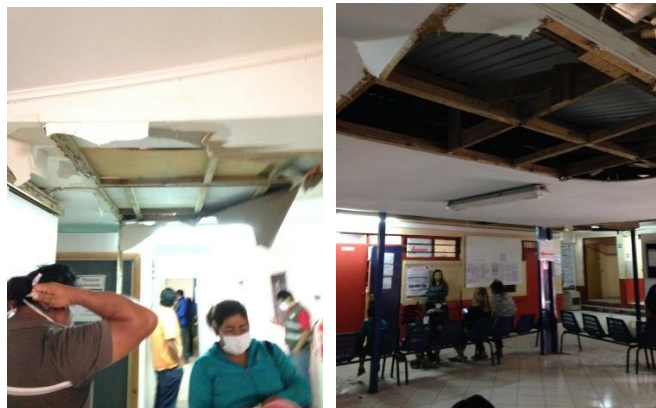
Fotografía 12. Daños en los cielos en el CESFAM Pedro León Gallo. Tomado de (Gobierno de Chile, 2015a).
