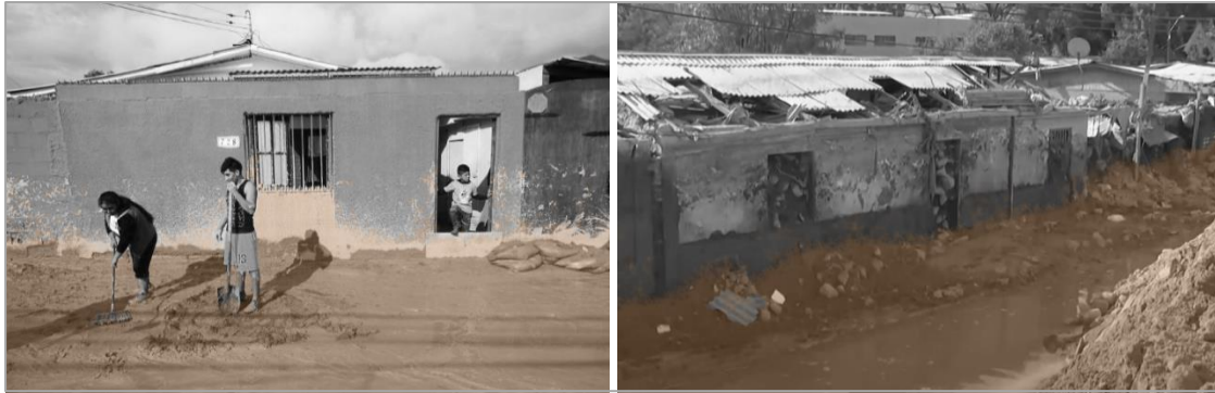
Fotografía 6. Daños y altura de flujos de detritos y de barro en edificaciones de la ciudad de Copiapó por el aluvión de 2015. Elaboración propia en base a Atacama Viva TV (2015); Devastador amanecer en Copiapó Paipote tras fuertes lluvias y aluviones (2015); Reconstruyamos Paipote (s. f.); y Radio Duna (2015).
