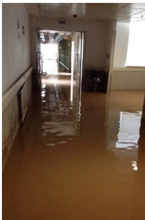
Fotografía 3. Nivel de inundación en los pasillos del Hospital de Copiapó tras el aluvión de 2015. Tomado de 24Horas, s.f. a.
