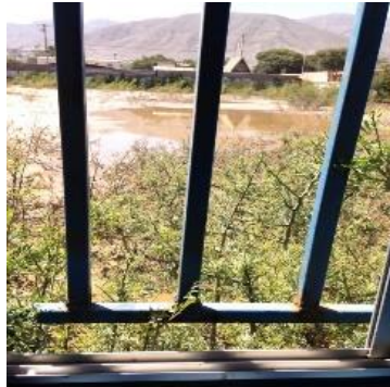
Fotografía 8. Estado de las protecciones de las ventanas. Tomado de (Gobierno de Chile, 2015a).
