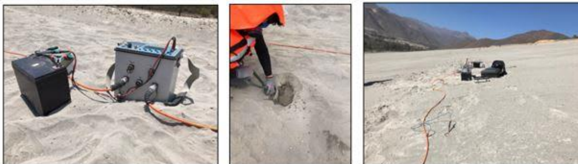
FIGURA 11. FOTOS DE LA INSTALACIÓN DE LOS PERFILES ERT 2D SOBRE EL TALUD DEL MURO DEL TRANQUE DE RELAVES.
