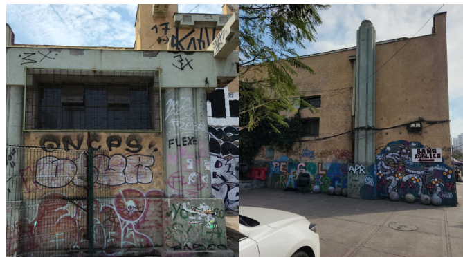
Imagen 25. Daños, interior y exterior, 2023 Fuente: Elaboración propia
