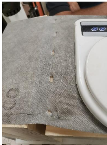
Figura 43: Desgarro en membrana Ultrafieltro. Nota. Elaboración propia, 2022
