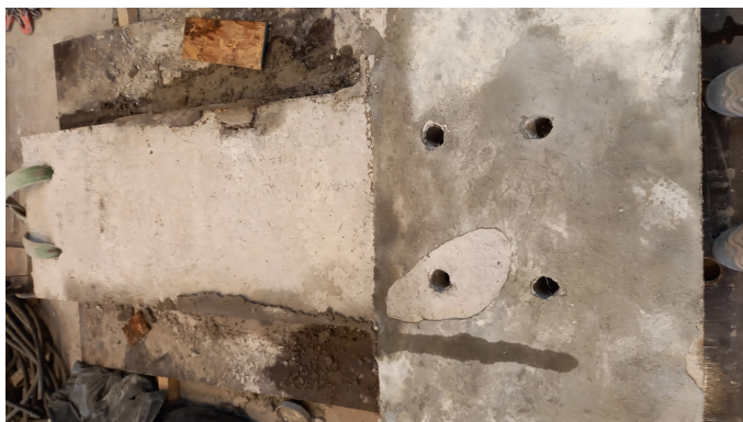
Figura 3.15: Fundación antes de la reparación
