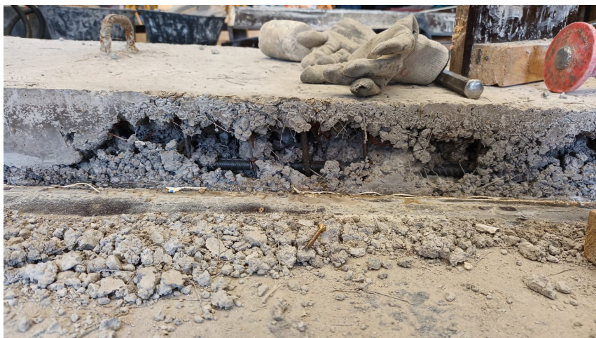
Figura 3.14: Mal hormigonado borde muro 2
