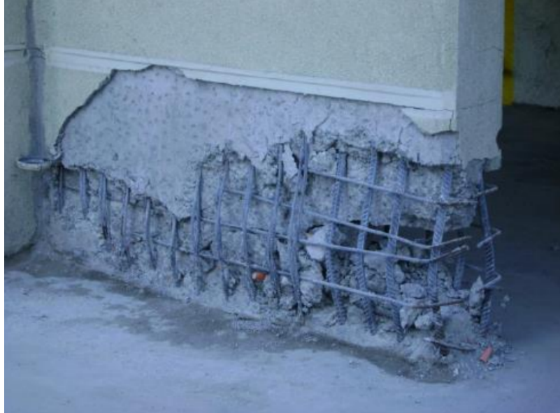
Figura 3.8: Imagen del daño sufrido por el muro marcado en rojo en el primer piso (Leiva et al., 2010).
