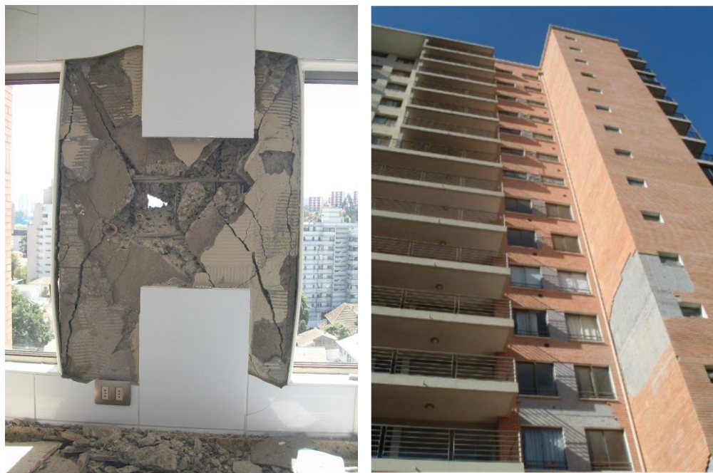
Figura 3.10: Daño por corte en la fachada norte (Leiva et al., 2010).
