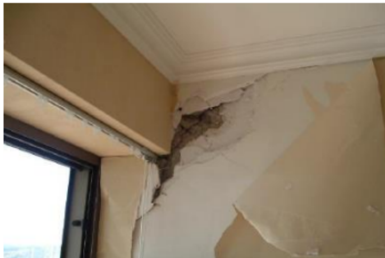
Figura 3.15: Daño en la conexión muro-viga (Leiva et al., 2010).
