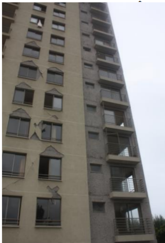
Figura 3.11: Daño por corte en la fachada oriente (Leiva et al., 2010).
