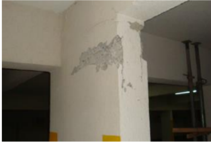
Figura 3.6: Imagen del daño sufrido por el muro marcado en azul en el primer subterráneo (Leiva et al., 2010).
