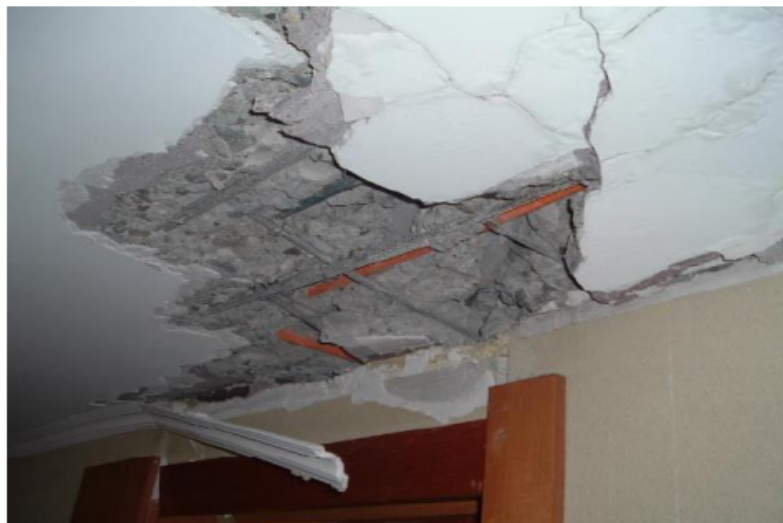
Figura 3.13: Daño en una de las losas (Leiva et al., 2010).
