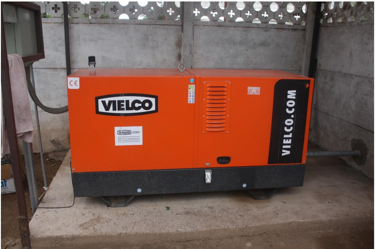
Figura 7. Generador trifásico, Villorrio El Talhuén.
