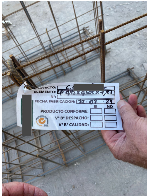
Figura 3.67: Identificación refuerzo grada prefabricada en planta de producción. Fuente: Imagen propia, visita a planta de producción.
