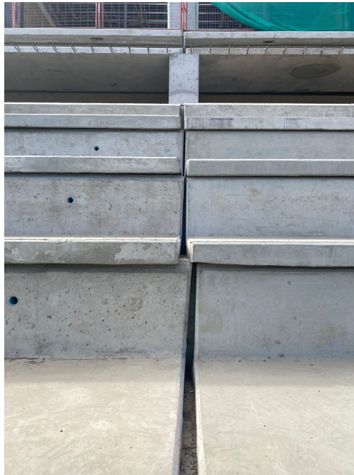
Figura 3.69: Descalce geométrico de gradería prefabricada puesta en obra. Fuente: Imagen propia, visita a planta de producción.
