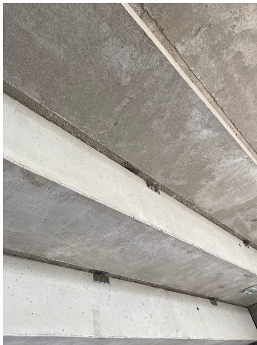
Figura 3.70: Descalce entre placas de inserto de dos graderías montadas en obra. Fuente: Imagen propia, visita a planta de producción.
