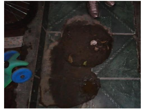
Fig. 73: Bache de pasillo entrada principal. Archivo personal
