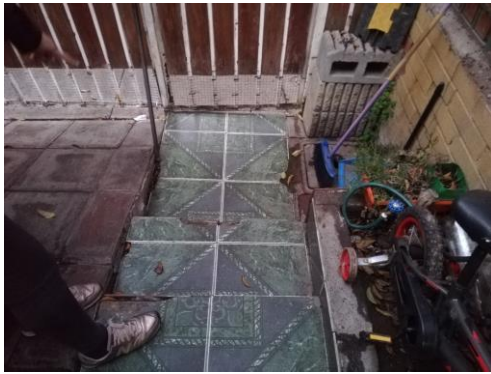
Fig. 71: Entrada principal. Se observan peldaños y objetos alrededor del pasillo como obstáculos. Archivo personal
