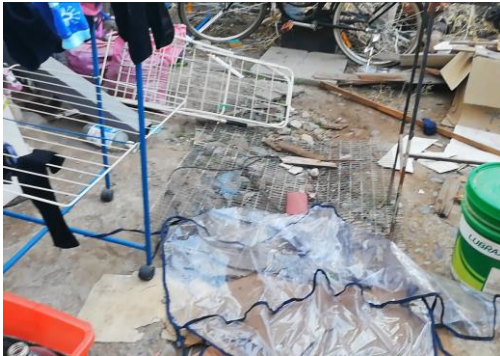
Fig. 48: Suelo de patio trasero, presencia de humedad que ingresa a la habitación de la participante, hundiéndose el piso con él.
