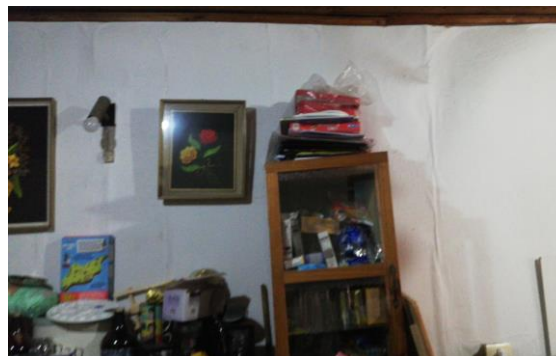
Fig. 55: Comedor. Cableado eléctrico sin revisión actualizada. Se presencia humedad en las paredes, levantando el papel mural.
