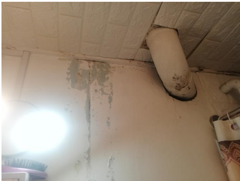
Fig. 67: Presencia de humedad filtrada en paredes y cielo del baño de la participante. Archivo personal
