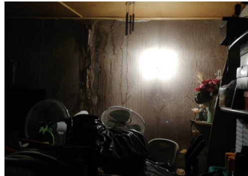
Fig. 52: Presencia de humedad, habitación utilizada momentáneamente para almacenamiento.
