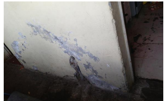
Fig. 53: Humedad presente en muros de hormigón y descascaramiento de pintura. Muro de cocina.
