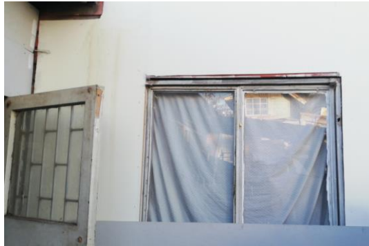
Fig. 49: Ventana de habitación de la participante, orientada hacia el patio trasero. No posee un correcto sellamiento, lo que permite infiltración de aire.
