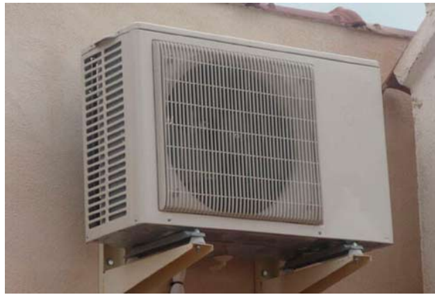
Figura 1.3: Condensador común de un sistema de aire acondicionado
