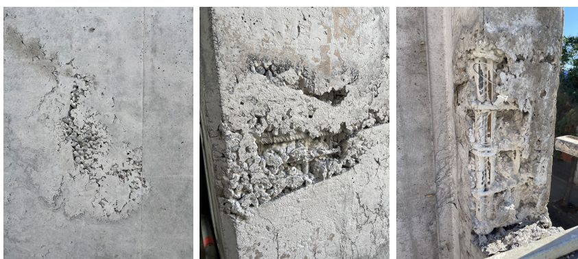
(a) Nido Superficial. (b) Nido Profundo. (c) Nido Estructural.
