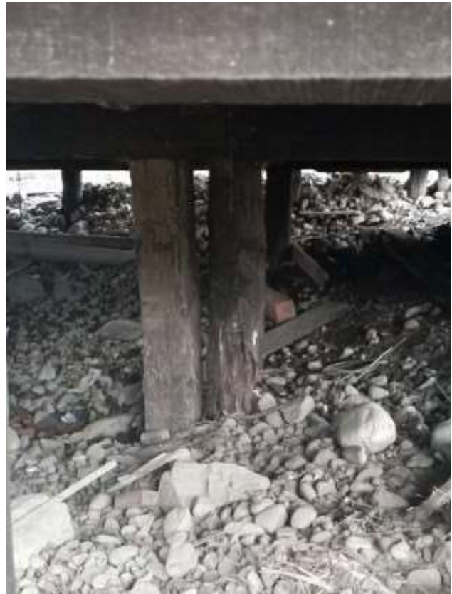
Figura 27. Pilotes de madera con desgaste. Elaboración propia.
