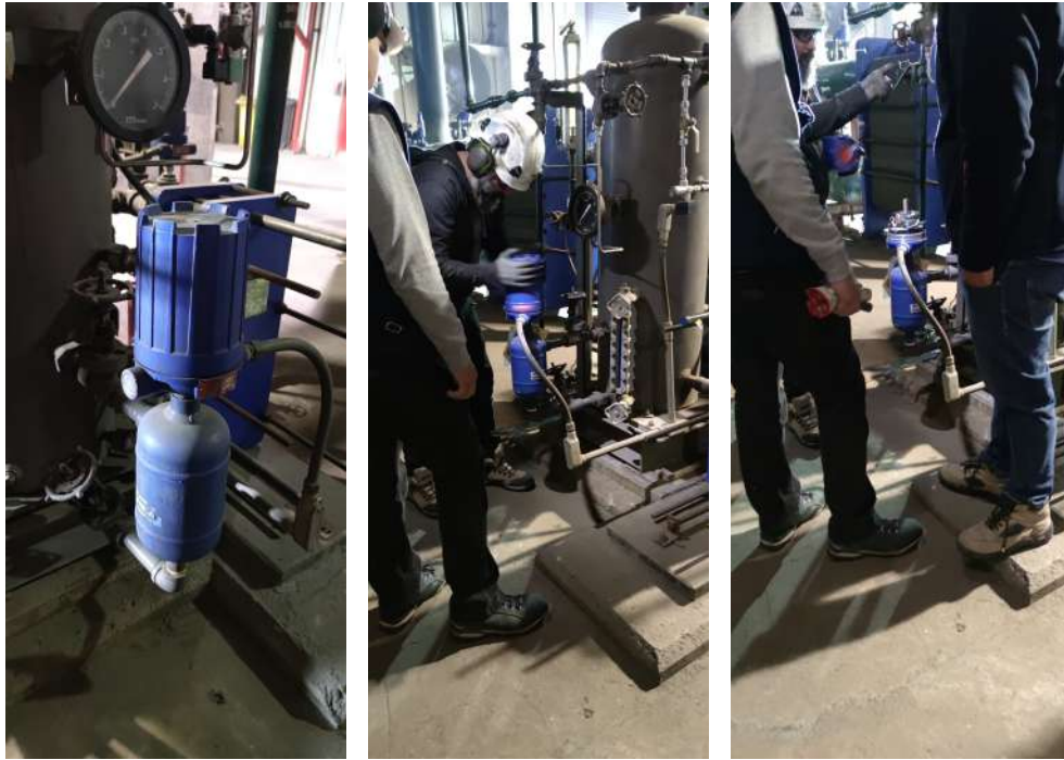
(a) Interruptor de nivel tapado
