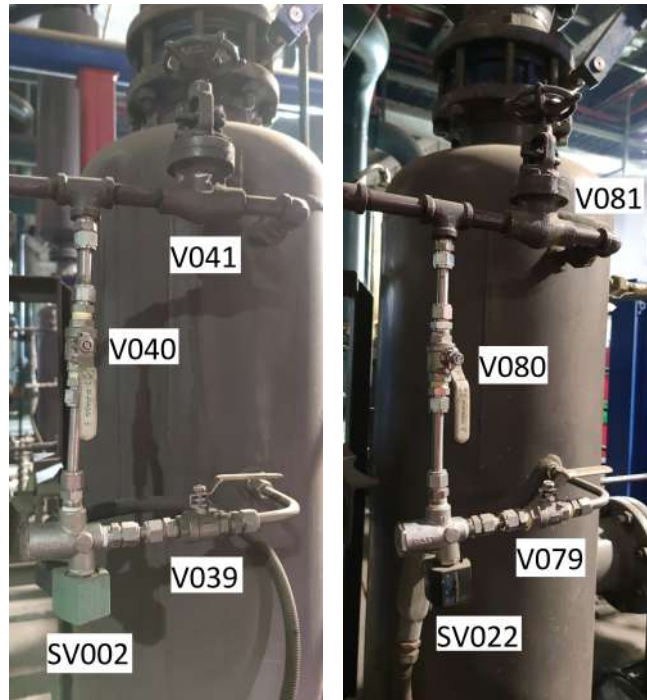
(a) SV002 en bomba A (b) SV022 en bomba B
