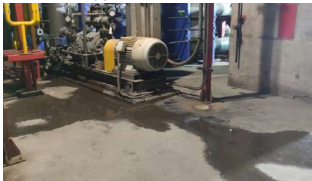
(b) Fugas en la bomba
